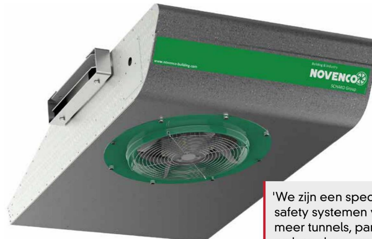
Voor een gezonde lucht in de ondergrondse parkeergarage werd een ventilatiesysteem met 10 CGF 500 stuwkrachtventilatoren geïnstalleerd.
